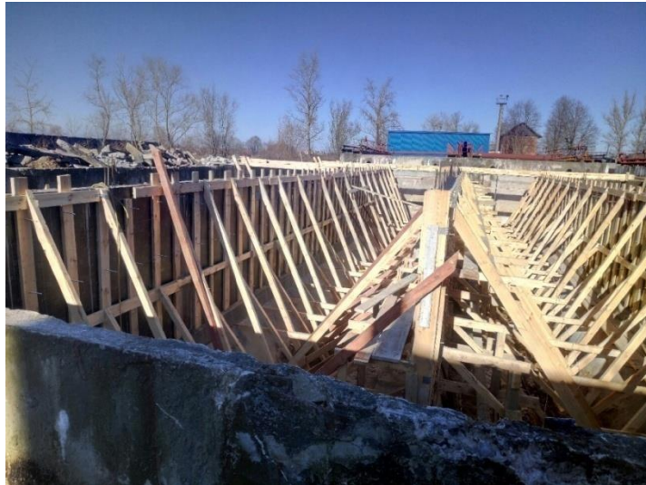
Рис. 2. Переобладнання аеротенка-освітлювача в біореактор нітриденітрифікатор
