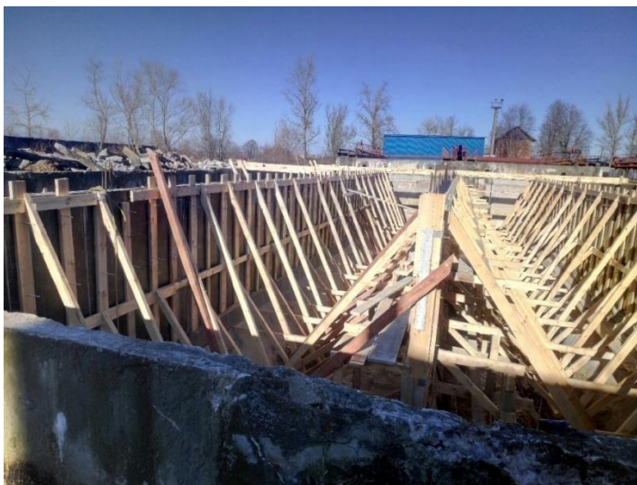
Рис. 2. Переобладнання аеротенка-освітлювача в біореактор нітриденітрифікатор
